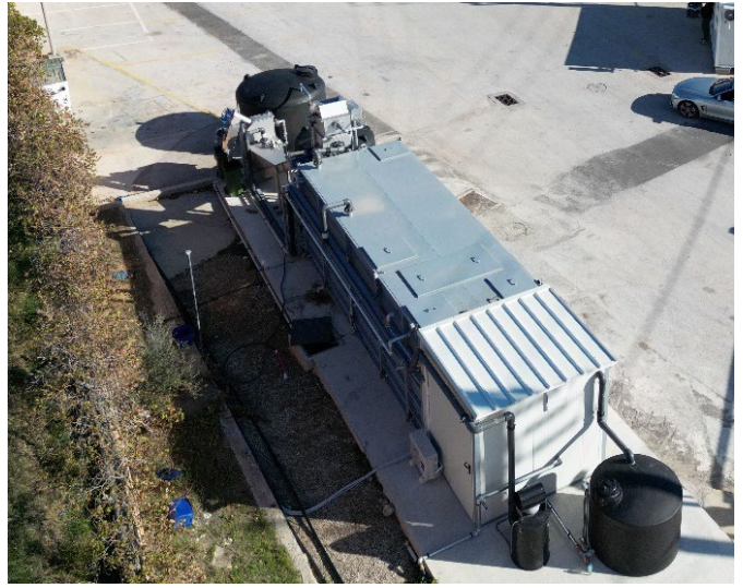
Προ-συναρμολογημένη εγκατάσταση εντός container
